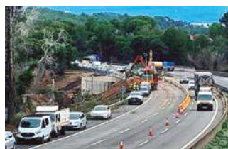
Zona de plataforma afectada por las obras en la AP-7 en sentido Sur. Foto Autor.
