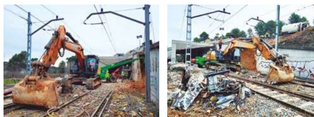
Fotografías de Autor de los equipos de trabajo en la zona afectada.
